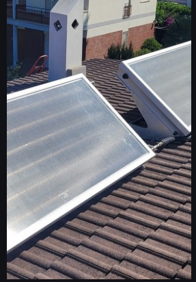
Solar thermal / renewables.
