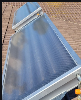
Solar thermal · integration.
