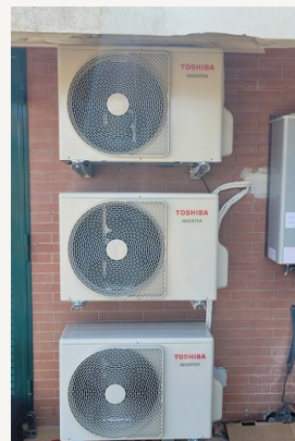
Unidades exteriores / distribución.
