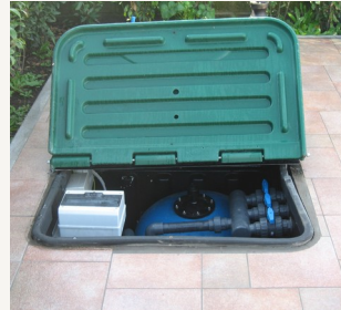
Sala técnica enterrada.
