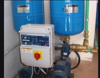
Grupo de presión y presurización.
