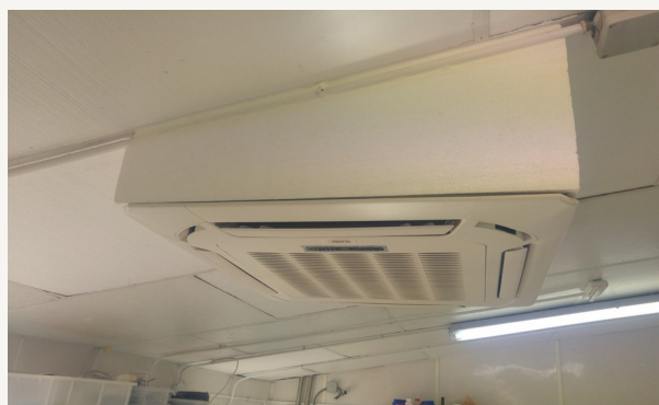
Climatización tipo cassette • laboratorio en Madrid.
