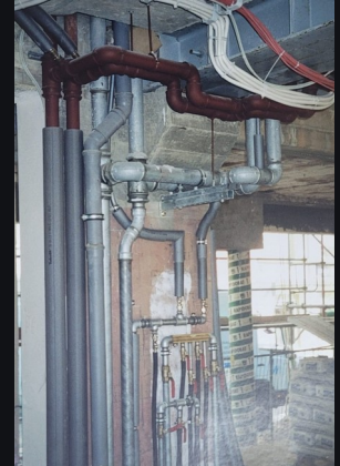
Montantes y redes técnicas.
