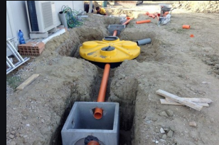
Tratamiento/depuración de aguas.
