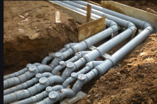
Redes enterradas y desagües.
