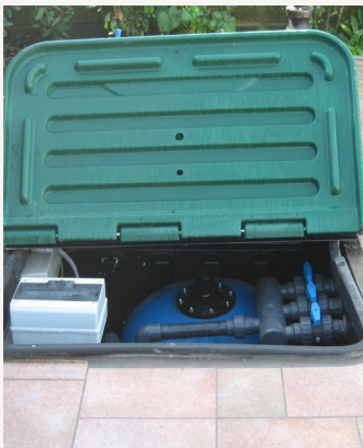
Sala técnica enterrada.
