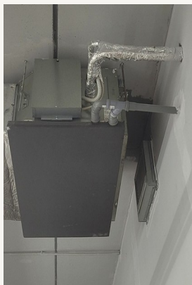
Renovación de aire y ventilación.
