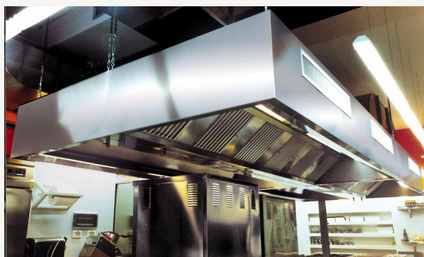
Extracción profesional • cocina / restauración.
