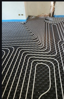
Pannelli radianti a pavimento.
