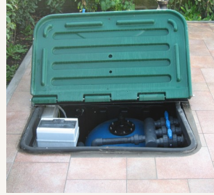
Locale tecnico interrato.
